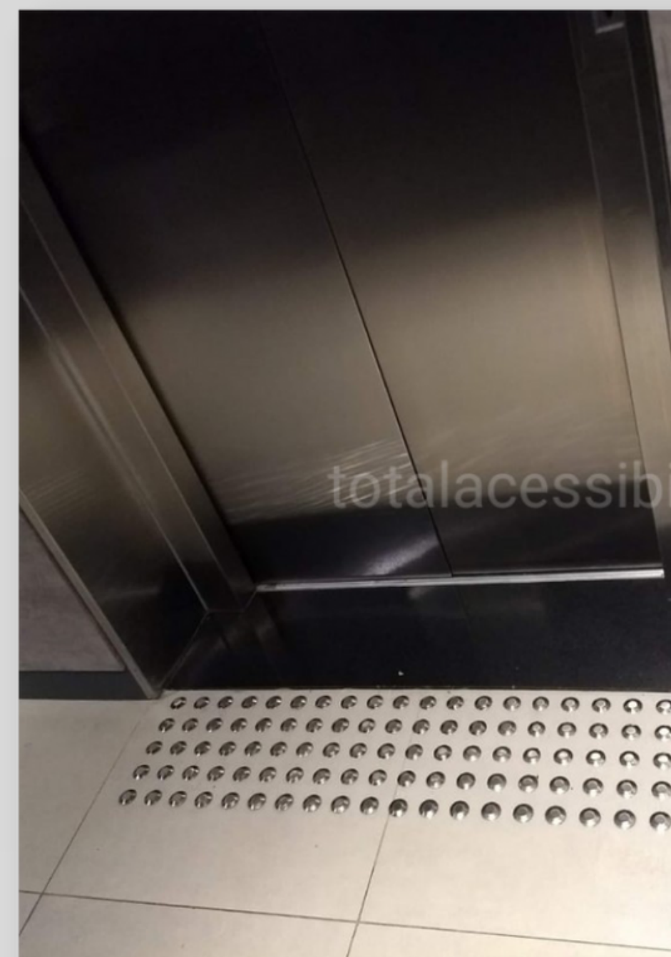
FOTO ILUSTRATIVA DO PISO TÁTIL INOX MODELO ALERTA - INSTALADO NA ENTRADA/SAÍDA DO ELEVADOR
